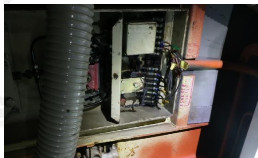
圖 27 EMU1200 型 VCB 下方之控制電路
