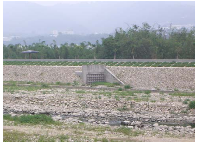
照片 16: 自動式的閘門
